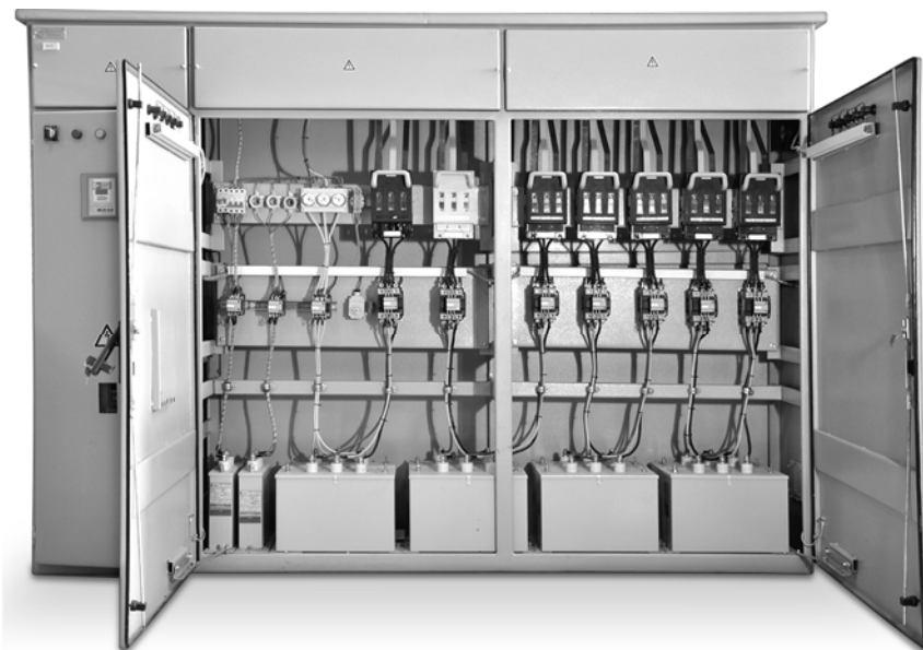
شکل (۸-۷۲): نمونه ای از یک تابلو برق قدرت
