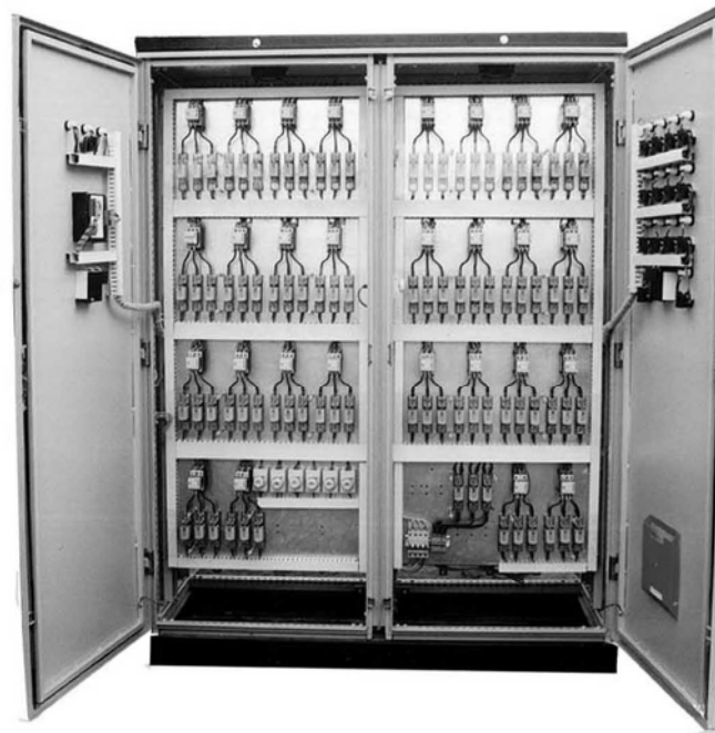
شکل ( ۸-۷۱): نمونه ای از یک تابلو برق
